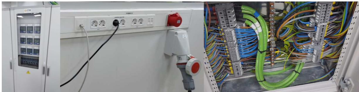
Figura 26. Cuadro de medida del sistema físico de análisis energético y ejemplo de tomas eléctricas incableado de medida y alimentación eléctrica. Fuente: ITE
