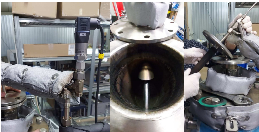
Figura 6. Desmontaje y comprobación de funcionamiento de los distintos elementos de la planta del reactor durante el SAT en instalaciones del proveedor. Fuente: ITE
