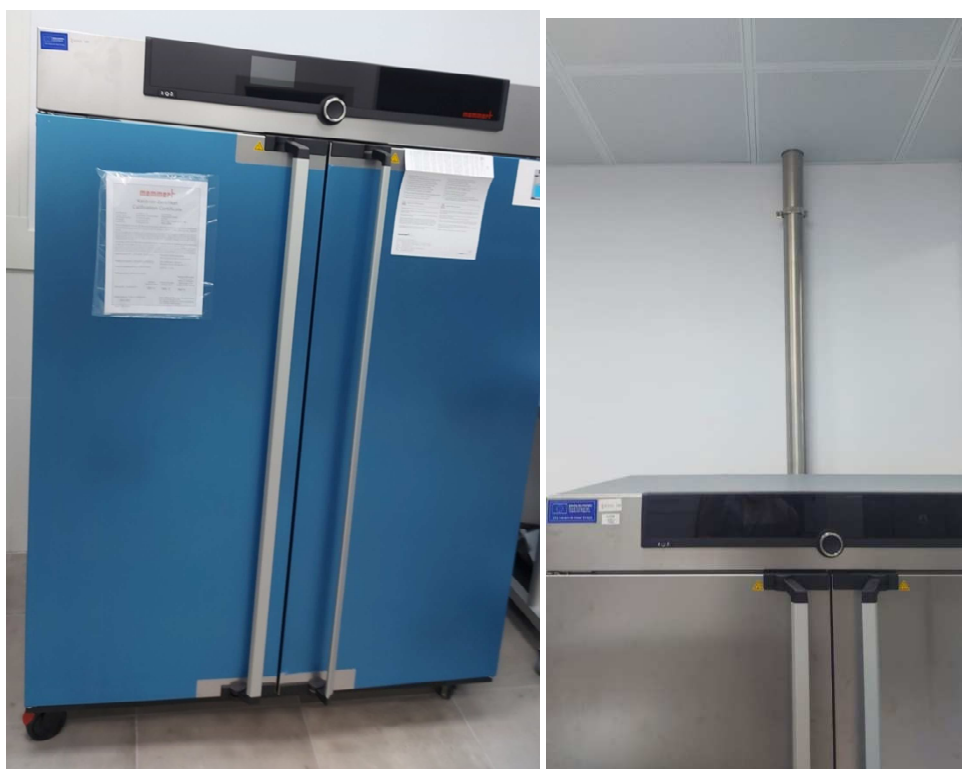
Figura 3. Estufa de presecado de biomasa adquirida e instalada. Fuente: ITE
