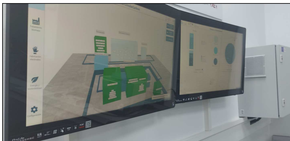
Figura 27. Sistema digital análisis energético instalado en ITE y monitores de visualización. Fuente: ITE.
