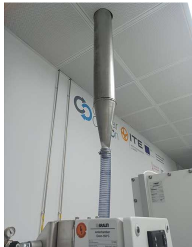
Figura 12. Imagen del sistema de extracción de caja de guantes CIRCULARCARBON
